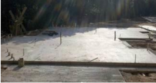
Figura 8: Elemento de fundação – diferença de cota entre calçada e piso interno
