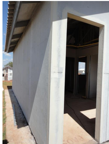
Figura 16: Fechamento da face externa dos quadros estruturais com placa cimentícia e requadro de vão com acabamento em placas cimentícias
