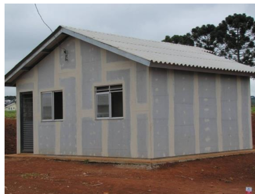
Figura 2 – Fechamento da face externa dos quadros estruturais com placas cimentícias em uma unidade habitacional térrea
